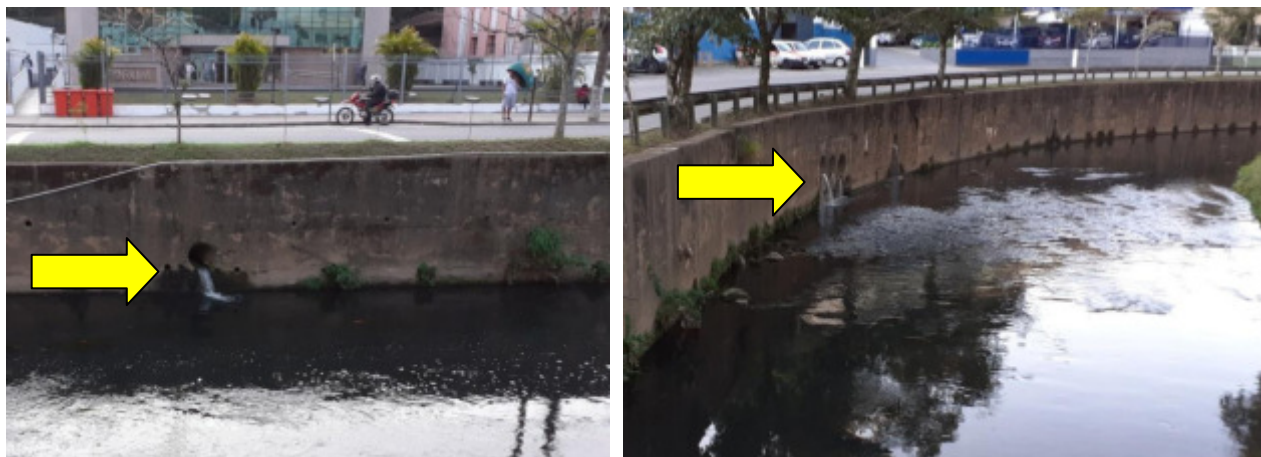
Figuras 3.1-5 e 3.1-6: Detalhe do deságue da rede de drenagem do Ponto 1.
